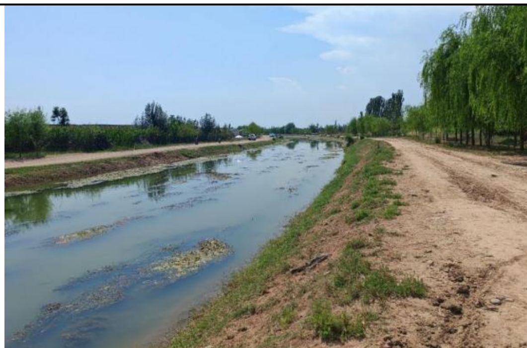
图 3-5 第五排水沟 21+044 处夏天现状图（出自《第三、五排平罗段水系连通工程初步设计报告》）
