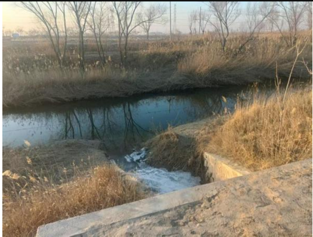
图 3-4 第三排水沟 25+810 处冬天现状图
